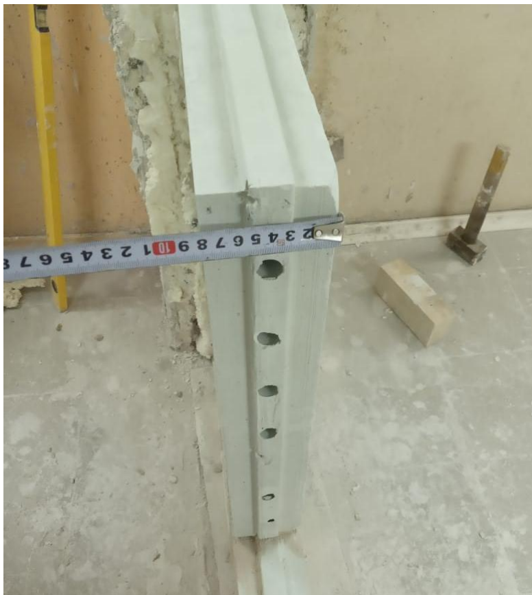
Фото 1. Изготовление фрагмента перегородки в акустической камере, (плиты гипсовые пазогребневые пустотелые гидрофобизированные ПЛГН1 размером 667x500x80)
